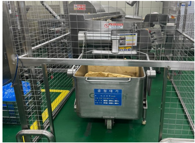
부속설비 볼 리프터 방호울
