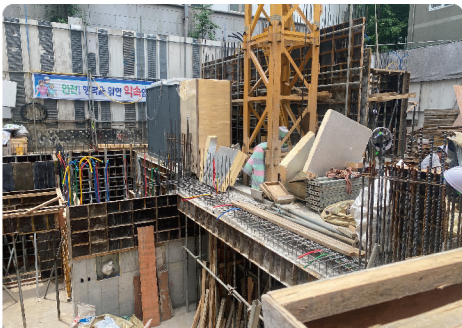
〈개선 전〉 철근 배근된 바닥 단부 안전난간 미설치
